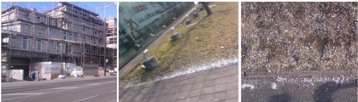
Abbildung 6: Beispiel für einen Eintrag durch umweltoffene Anwendung: Styroporkügelchen von Dämmplatten, die beim Fassadenbau verwendet werden (© Umweltbundesamt/Hauzenberger).
